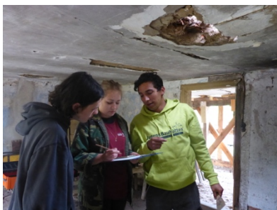
Erforschen: eine AG untersucht ein beschädigtes Deckengefach
